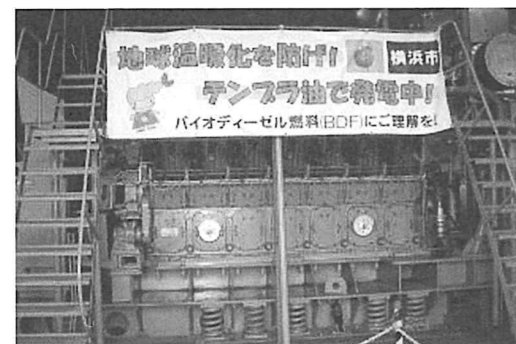
▲大型エンジン発電機 横浜市(重油との混合使用)
